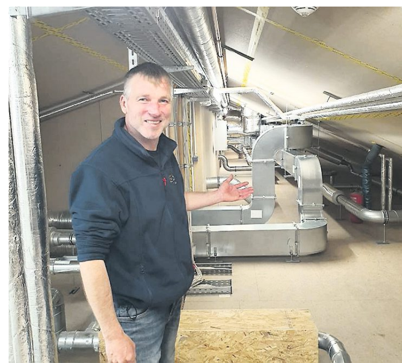
Unterm Dach des Neubaus steckt viel Technik, erklärt Udo Dörsam.
